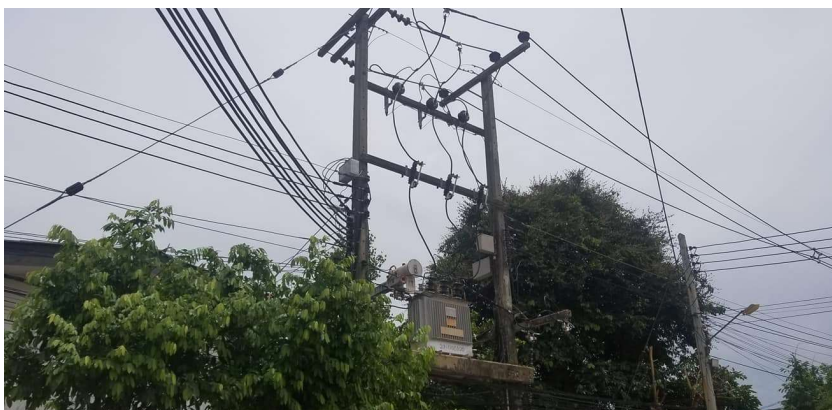
รูปภาพที่ ๑ ภาพหม้อแปลงไฟฟ้าก่อนการปรับปรุงของโรงพยาบาลห้วยทับทัน
